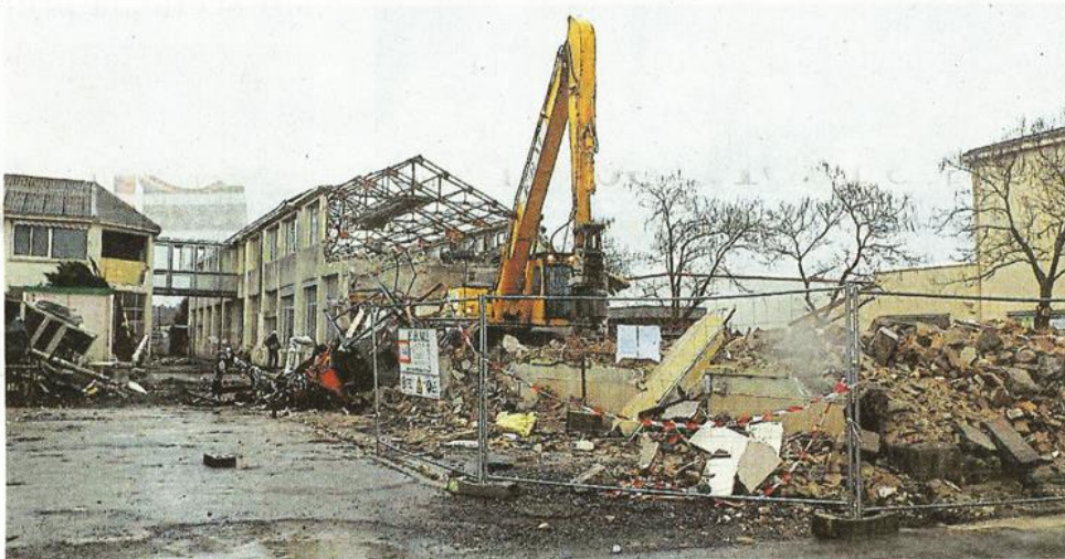
La redynamisation du centre-bourg passe par la destruction de l'immeuble Bodet. La nouvelle physionomie du bourg se dessine : à droite la pharmacie Fonteneau avec, en arrière-plan, la structure de la nouvelle supérette.
